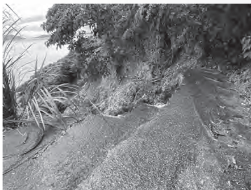
大雨被害で崩落した道路
